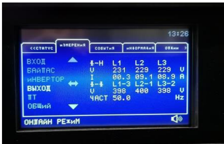
Рисунок 3 – Значение тока нагрузки на выходе ИБП
