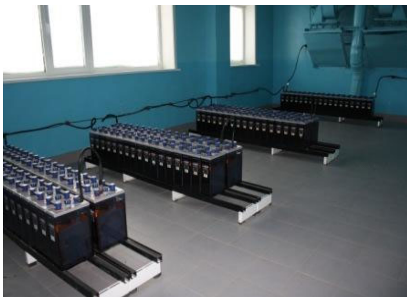
Рисунок 1 – Расположение СКБ в аккумуляторном помещении
